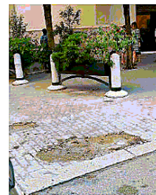
Pericolo Il passaggio pedonale è difficoltoso in via Borelli
